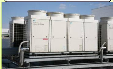
高効率空調設備
