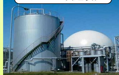
バイオマス利用メタンガス製造装置
